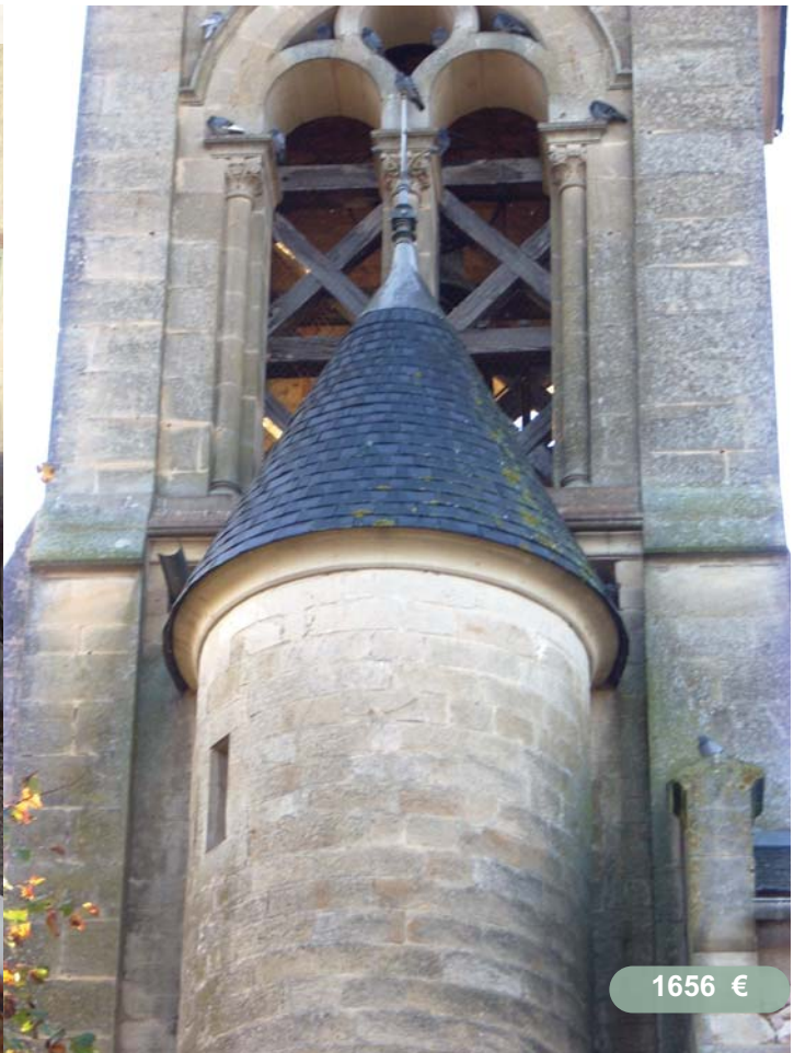
Etanchéité de la couvertine de l'église de Mauroux.
